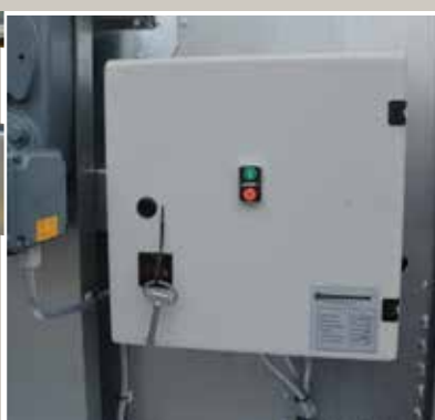
Panou de comanda pentru pornirea si oprirea tuturor motoarelor selectorului KDC 8000
